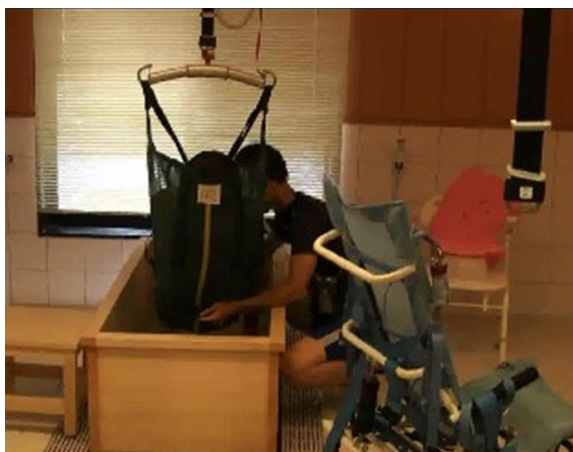
図5 天井走行リフト
